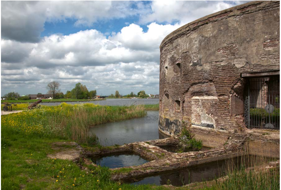
Het in 2007 gerestaureerde torenfort Uitermeer in Weesp, onderdeel van de Nieuwe Hollandse Waterlinie. Foto: RCE.
